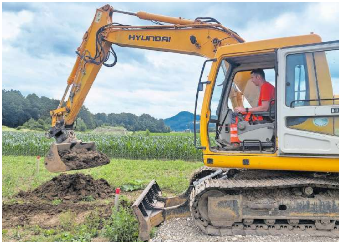
Die Bauarbeiten für die Umsetzung des nationalen Wildtierkorridors AG 1 im Möhlinerfeld laufen seit einigen Wochen.
